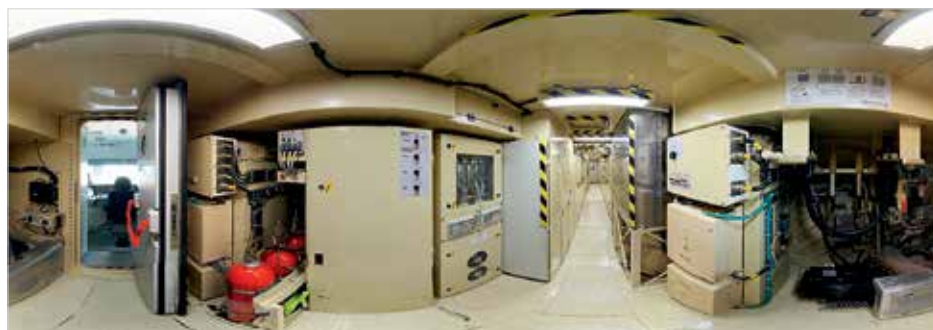
Panoramatický pohled do strojovny.
