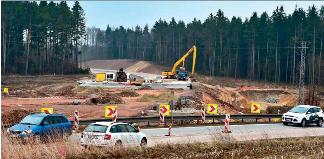
ČEKÁNÍ NA OBCHVAT. Na severním okraji Budějovic se zatím buduje tříkilometrový úsek dálnice, který odvede dopravu z předměstí Borek a Nemanice. Navázat má velký obchvat města za čtrnáct miliard korun.
