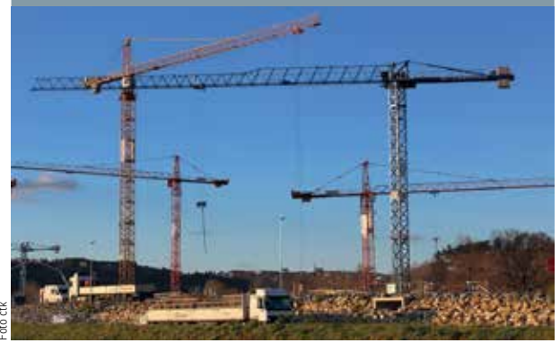
STAVEBNÍ RUCH V BUBENČI. Nová čistírna bude po svém dokončení schovaná prakticky celá pod zemí.
