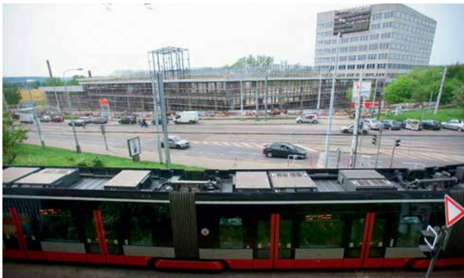
ROZESTAVĚNÁ RADNICE. Nová Palmovka měla z větší části sloužit jako kanceláře pro radnici Prahy 8. Práce na stavbě se však již více než před rokem zastavily.
