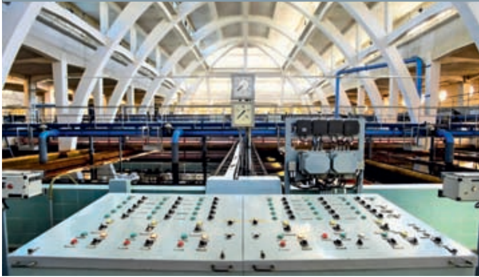
VODÁRENSKÁ KATEDRÁLA. Vodárna v Podolí byla postavena podle plánu architekta Antonína Engela a zahájila provoz v roce 1929. Nepřetržitě zásobovala Pražany do roku 2002.
